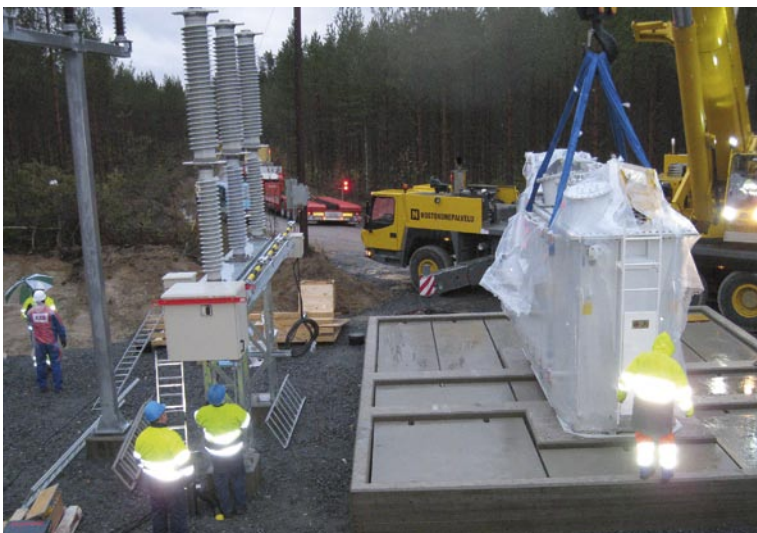
Haapamäen sähköaseman yhtiölle toimitti ABB. Perustustyöt suoritti Rakennusliike Timo Nyssölä Oy Ähtäristä.
